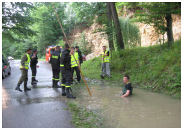
Zatkany przepust przy drodze powiatowej w Hermanowej, wymagał interwencji Straży Pożarnej
